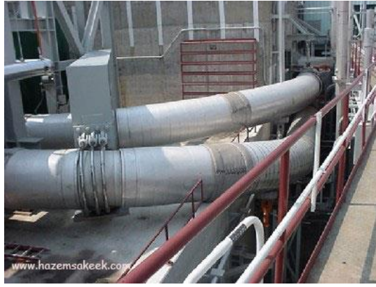
صورة توضح انابيب ضخ البخار المضغوط لتحريك التوربينات لتوليد الكهرباء
